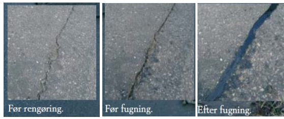
Eksempel på revne før og efter reparation
