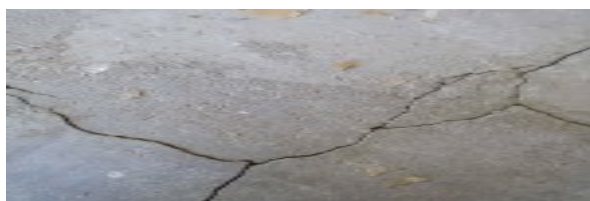
Revner som sandsynligvis skyldes dårligt underlag
